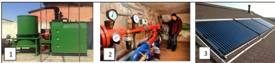
Рисунок 2 – 1. – Пример котла, работающего на опилках; 2 – Пример установки приборов учета; 3 – Пример установки солнечных коллекторов для ГВС
